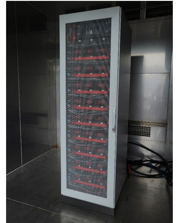
Тестирования HSC-накопителей компанией Digital Edge
